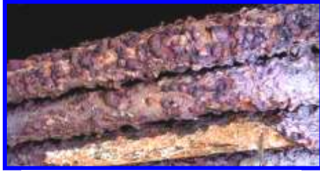
التآكل في أنابيب أحواض الطلاء.
