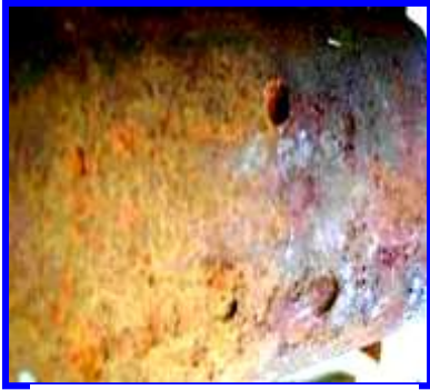
التآكل في أحواض الطلاء.
