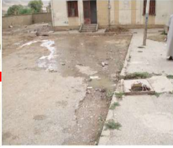
تدهور الطريق وتسرب مياه الصرف
